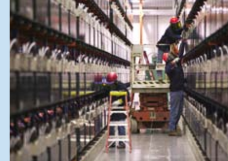
Japan gebruikt grote batterijbanken ter stabilisatie van het elektriciteitssysteem.
